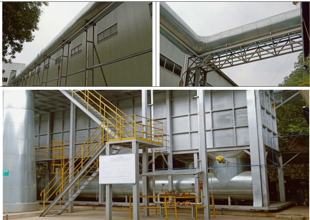
废气收集管道及 RTO 处理设施
