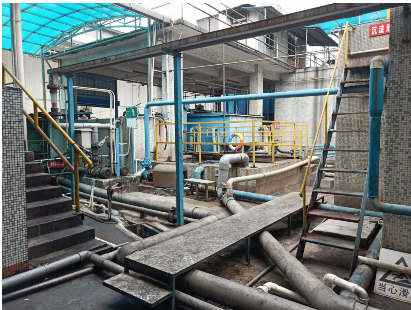
废水收集池周边管网
