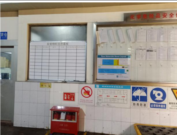
原辅料仓消防设施及安全生产制度
